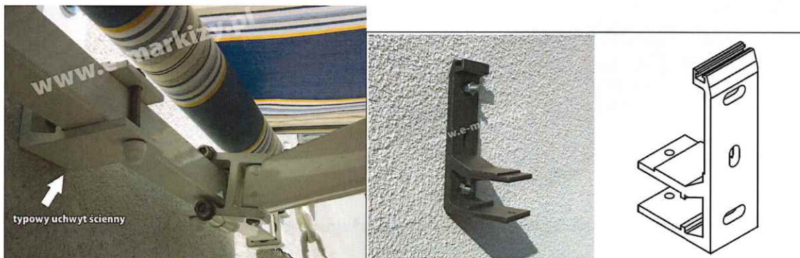
Rys. 18. Istniejące uchwyty ścienne do mocowania konstrukcji nośnej markizy
